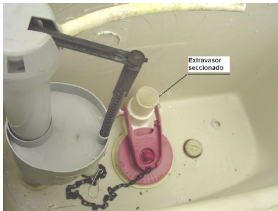
Foto 3: O interior da caixa acoplada e o tubo extravasor seccionado.
